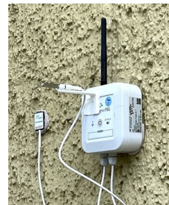
Abb. 1: Messsystem zur Bestimmung des Wärmedurchgangskoeffizienten ( U -Wert). Die Installation wurde zu Testzwecken am Gebäude TK auf dem Campus der School of Engineering der ZHAW durchgeführt. In der Abbildung wird ein Temperaturmessung an der Aussenwand dargestellt. Wichtig ist dabei, dass Wand-Oberflächen-temperatur und Lufttemperatur separat erfasst werden.
