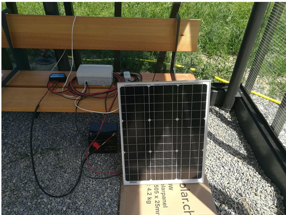
Abbildung 13: Photovoltaikanlage mit Steuerung
