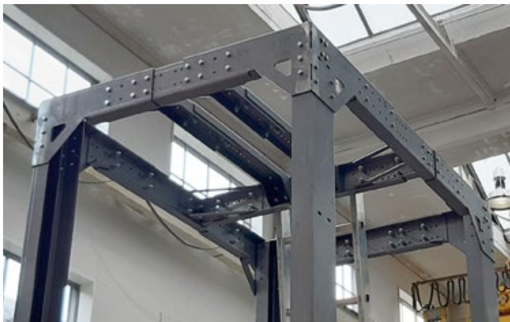
1 Das Bild zeigt den oberen Bereich der Lift-Konstruktion.
