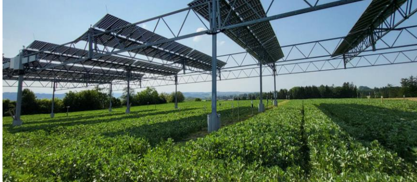
Forschungsanlage in Heggelbach (DE), Agri-PV über Ackerkulturen, Quelle ZHAW
