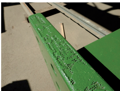
Aufgetretene Korrosionsschäden an Signaltägern in Tunneln (oben), Kontaktflächen (Mitte) oder porösen Grundmaterialien (unten) (Bild: Rickenbacher)
