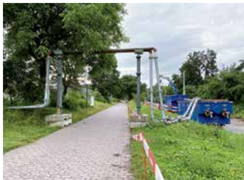
Rohrbrücke einer Pumpableitung in Höngg, Zürich Pipe bridge of a pump drain in Höngg, Zurich
