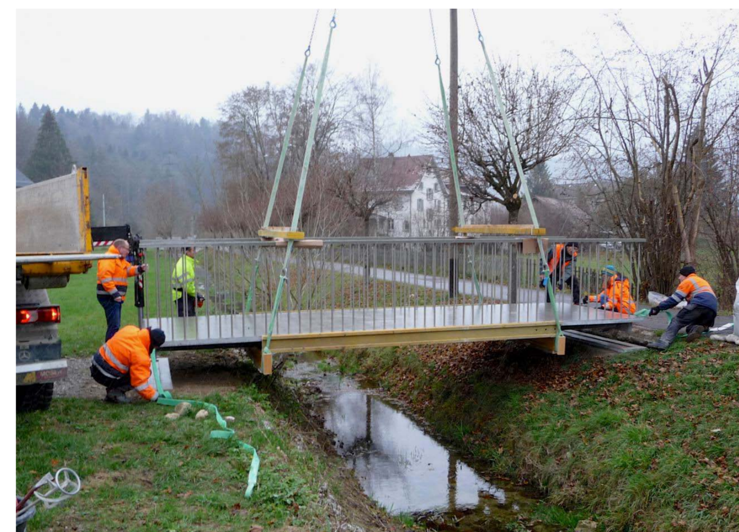
3. Setzung der Brückenplatte
