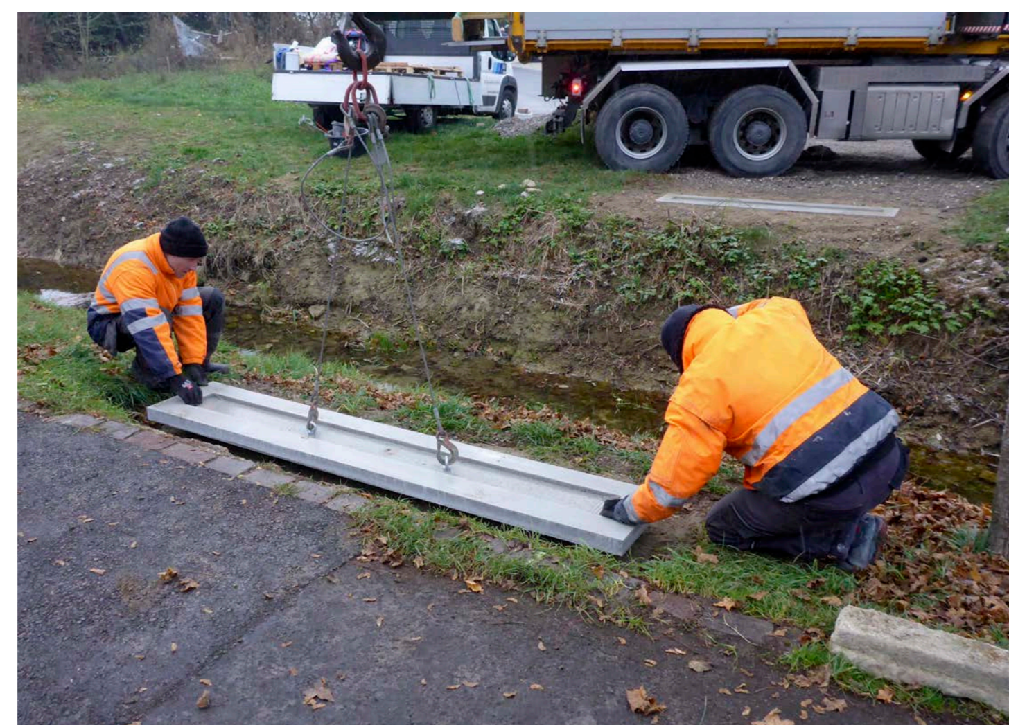
2. Fundamentplatte: kein Betonwiderlager, nur dünne Auflagerplatten
